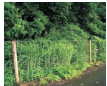
金網フェンス
